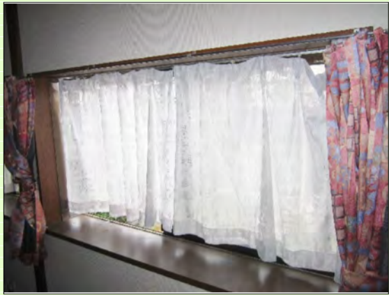
施工前：二階の出窓が結露して困っていました。
